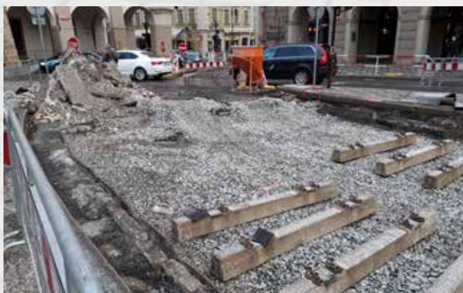
Pokládka pražců na ztuhlé štěrkové lože | Filling of sleepers with filler concrete
